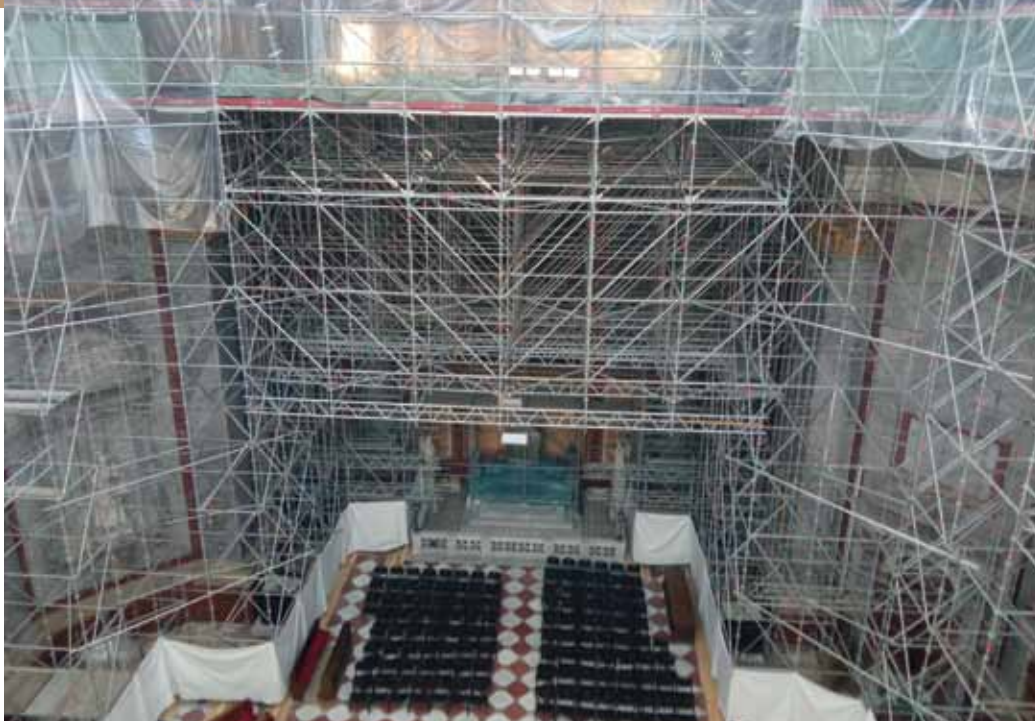
2. ábra. A 21 méteres magasság miatt a felmérés és a munkavégzés is csak egyedi, összetett állványrendszer megépítése után vált lehetővé
